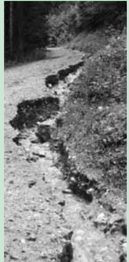
Enorme Schäden in Höhe von ca. 30.000 € hat das Hagelunwetter am 5. Juli an der Forststraße „Orterer Almweg“ in der Gemeinde Kochel am See angerichtet. Nachdem ca. 20 Durchlaßrohre wegen der abfließenden Wasser-, Eis- und Geschiebefracht verklebt waren, wurde der Wegekörper auf weiten Strecken entlang des bergseitigen Grabens metertief ausgespült. Die Reparaturarbeiten, die vom AELF Miesbach mit 80% der Nettobausumme gefördert werden, stehen kurz vor dem Abschluss.
